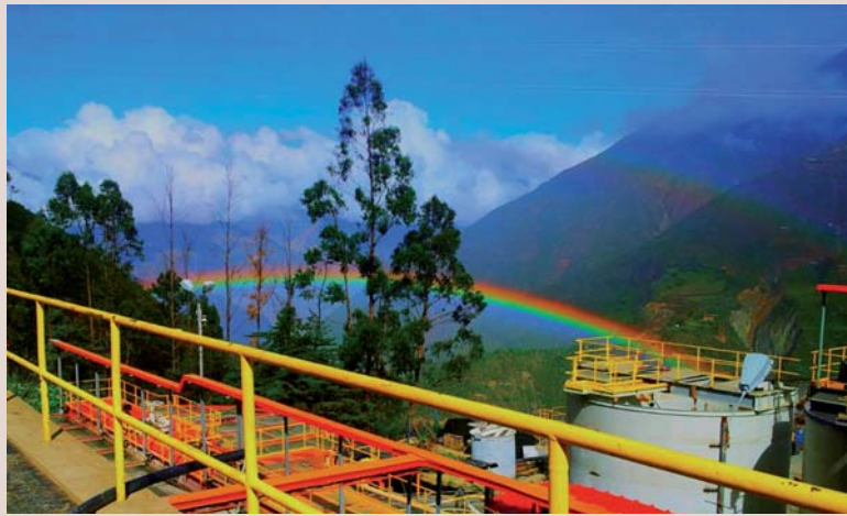
Primer Puesto: Marcos Urias Cuzco Tejeda, Mantenimiento.
