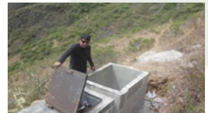
Caja para sistema de cloración San Fernando
