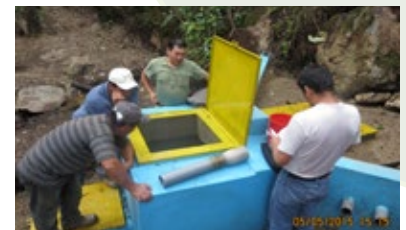
Captación Pueblo Nuevo
