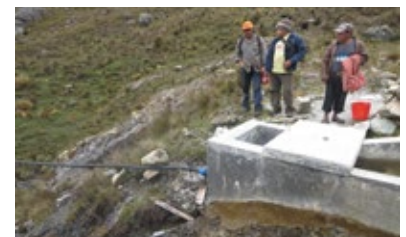
Captación Vista Florida
