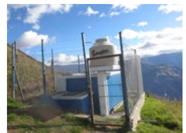
Sistema de cloración Socorro
